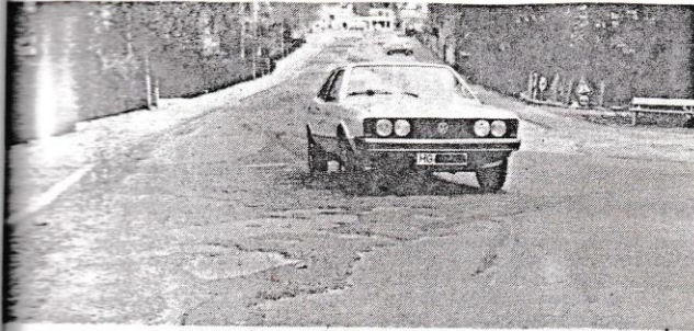
Der Borkenberg — derzeit noch Holperstrecke für Autos, soll schon bald eine neue Decke erhalten. Momentan kommt man sich als Autofahrer auf der Straße wie auf einem Stoßdämpfer-Testgelände vor.
