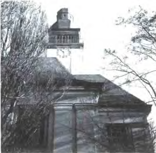
Auch die Christuskirche wurde durch die in der Nähe niedergegangenen Luftminen auf ihrer Südwestseite und im Inneren erheblich beschädigt.
